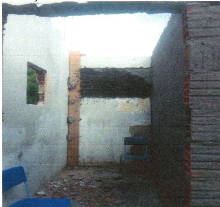
Foto 20 - CHAPISCO APLICADO EM ALVENARIA (COM PRESENÇA DE VÃOS) E ESTRUTURAS DE CONCRETO DE FACHADA, COM EQUIPAMENTO DE PROJEÇÃO. ARGAMASSA TRAÇO 1:3 COM PREPARO EM BETONEIRA 400 L. AF_06/2014
