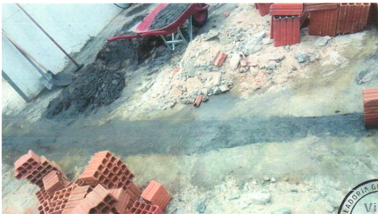
Foto 16 - CONCRETO FCK = 20MPA, TRAÇO 1:2,7:3 (EM MASSA SECA DE CIMENTO/ AREIA MÉDIA/ BRITA 1) - PREPARO MECÂNICO COM BETONEIRA 400 L. AF_05/2021
