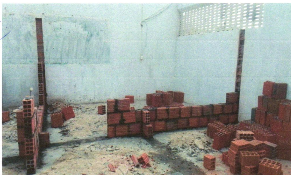
Foto 14 - ALVENARIA DE VEDAÇÃO DE BLOCOS CERÂMICOS FURADOS NA HORIZONTAL DE 9X19X29 CM (ESPESSURA 9 CM) E ARGAMASSA DE ASSENTAMENTO COM PREPARO EM BETONEIRA. AF_12/2021
